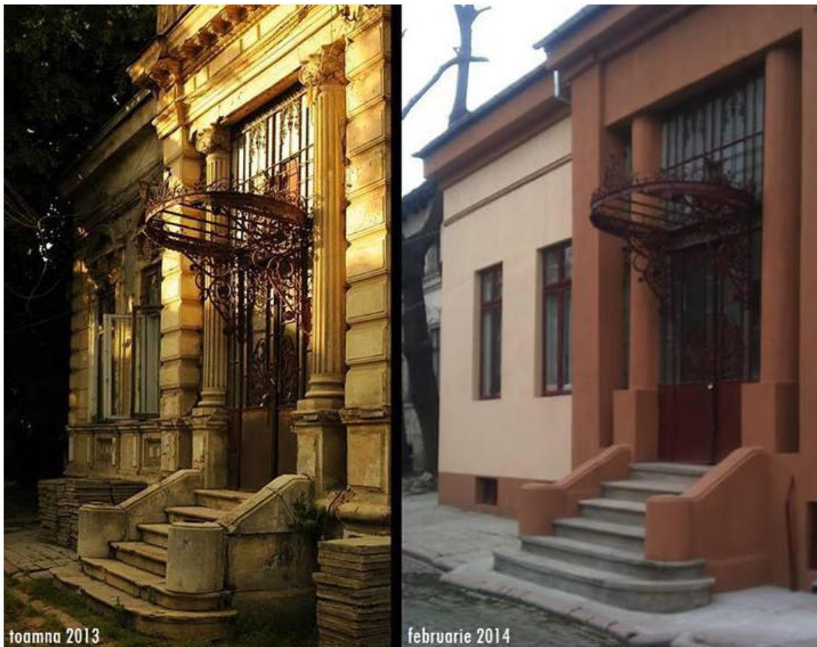
Figura 52: GREȘIT: Izolația termică exterioară, distrugerea elementelor arhitecturale ale fațadei, anularea completă a identității istorice a clădirii, zugrăvirea în culori neadecvate, imobil București
