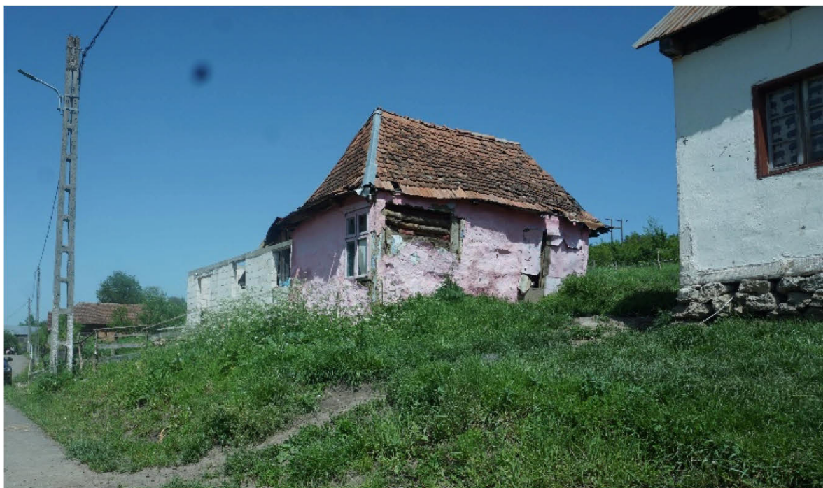
Figura 93: Pinticu, locuință în stare iminentă de colaps în care locuiește o familie cu patru copii. În plan îndepărtat, locuință în șantier de douăzeci de ani, care are în mijloc un bordei în care se locuiește de tot atâtat timp
